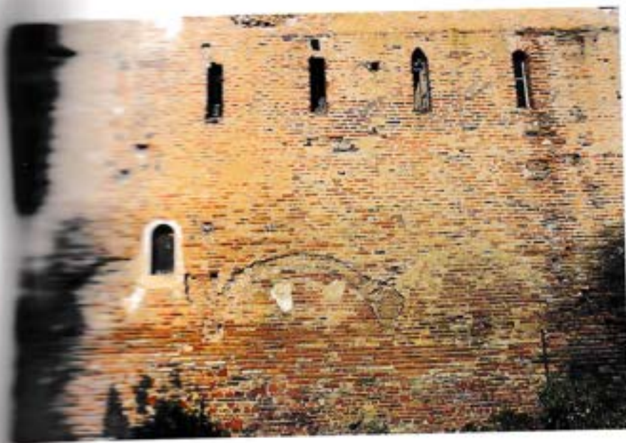
Vues de l'angle sud-ouest du cloître de plus en plus dégradé !
